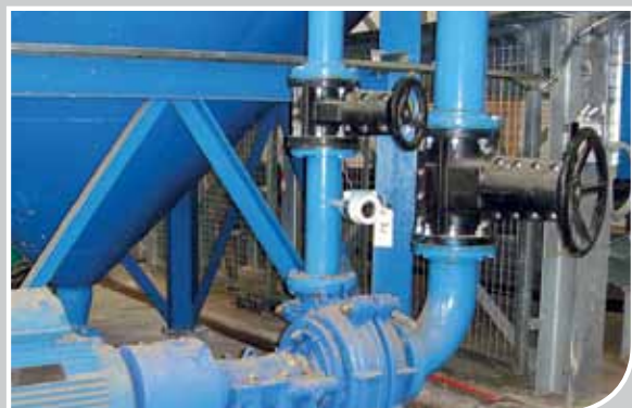
在Sims 金属再生公司的枫诺PVEG 阀门
