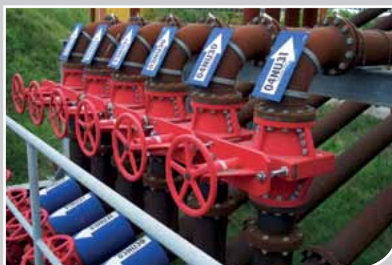
Использование пережимных клапанов Flowgoh на электростанции "DONG Energy"
